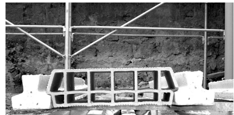
Fig. 6.31 - Sistemata la pignatta sui travetti precompressi si dispone l'armatura a momento negativo e l'armatura di ripartizione e poi si effettua la gettata di calcestruzzo.
