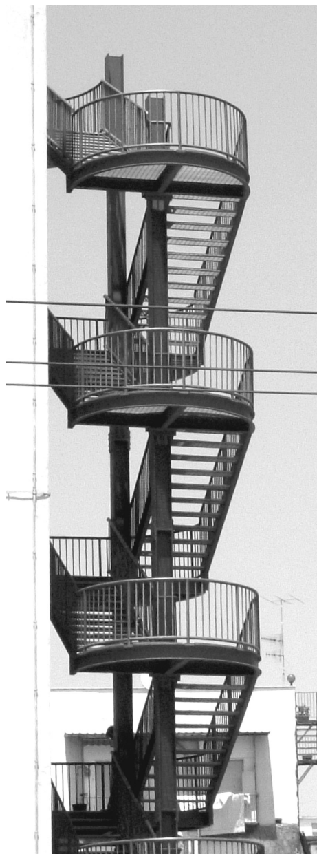
Fig. 6.38 - Scala di sicurezza esterna in acciaio
