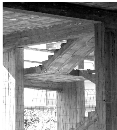
Fig. 6.37 - Scala realizzata con solaio rampante e gradini riportati. Anche in questo caso i gradini sono stati realizzati in cls e gettati contemporaneamente alla caldana del solaio. Si noti come un corretto sfalsamento permetta un perfetto allineamento degli intradossi di rampe e pianerottolo.
