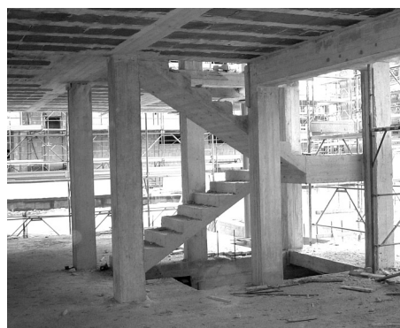
Fig. 6.36 - Scala realizzata con soletta rampante e gradini riportati. Nello specifico i gradini sono stati realizzati in cls e gettati contemporaneamente alla soletta. Si noti come l'assenza dello sfalsamento crei un antiestetico risalto all'intradosso del pianerottolo.
