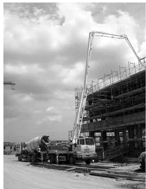
Fig. 6.41 - Attrezzatura di getto. In primo piano la pompa mentre dietro è visibile la betoniera che scarica nella vasca della pompa.
