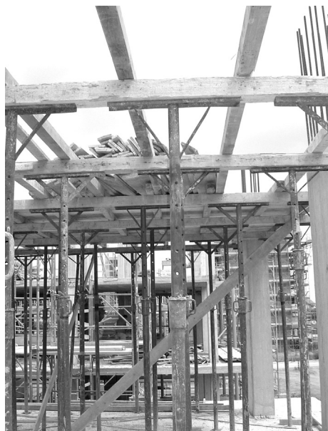
Fig. 6.23- Cassaforma continua per un solaio latero-cementizio gettato in opera in corso di realizzazione. Si notino i sostegni provvisoria T in ferro detti in gergo "cristi".
