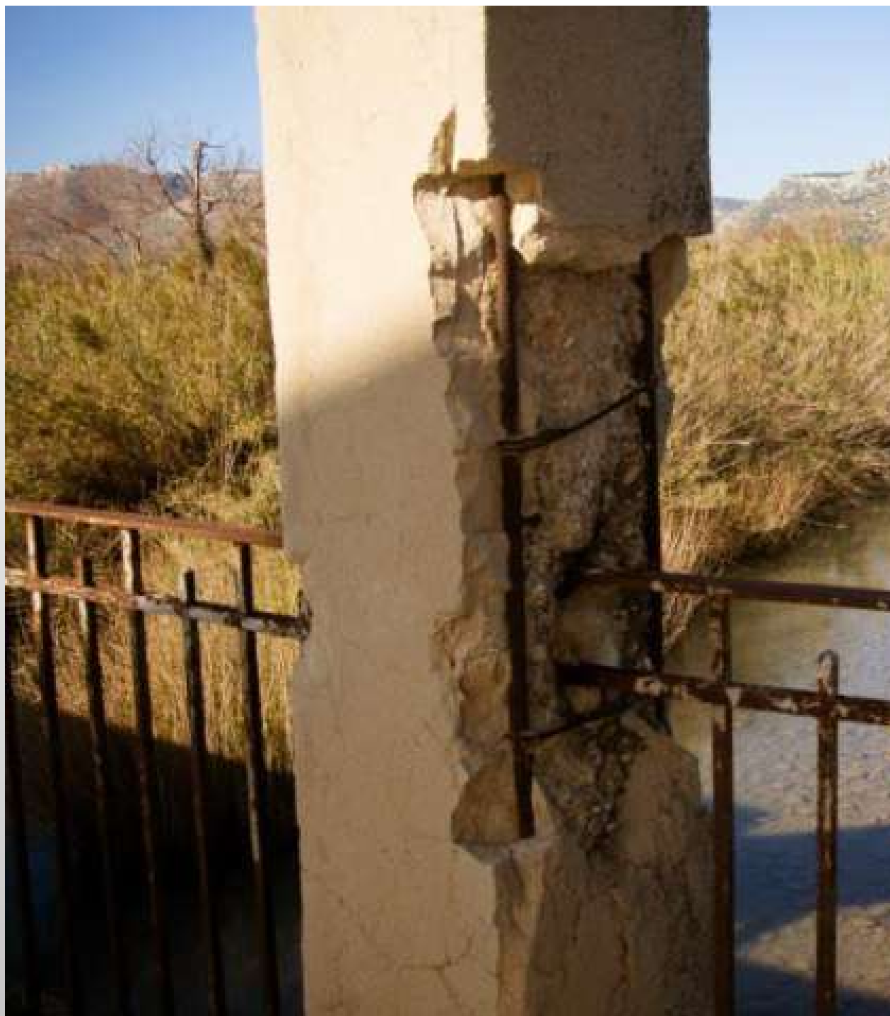
Pendini – Espulsione del copriferro, corrosione dell'armatura longitudinale e trasversale dei pendini
